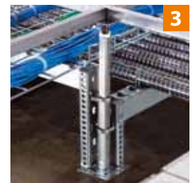
CABLOFIL BAJO PISO
